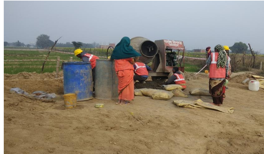
Pankha STP Site
