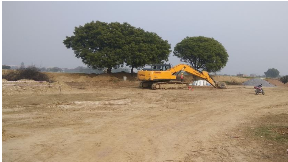
Pankha STP Site
