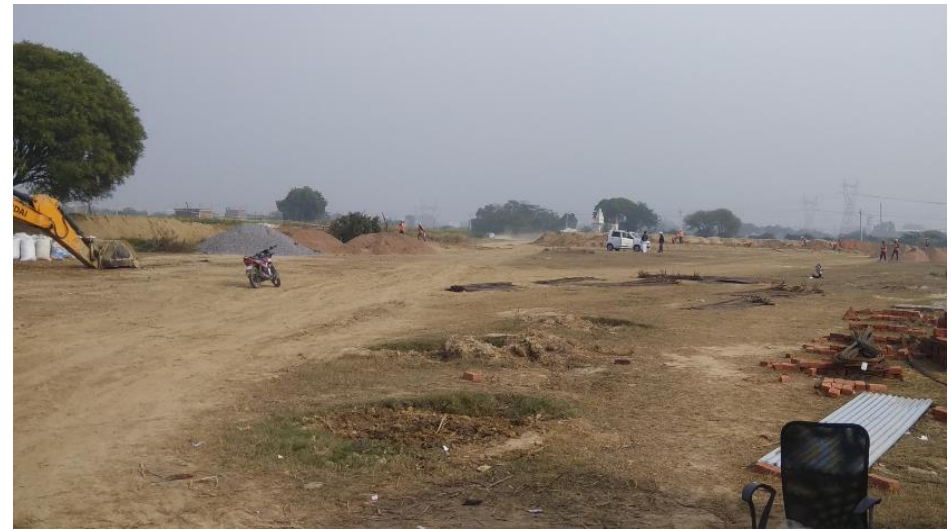
Pankha STP Site
