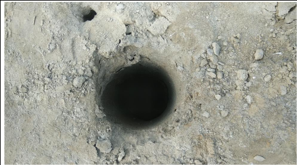
Unnao STP Site
